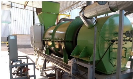
Figura 11 - Vista lateral do reator de pirólise.
